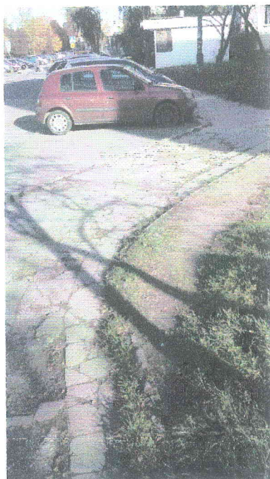
Stan chodnika na wskazanym odcinku (X 2017 r.)
