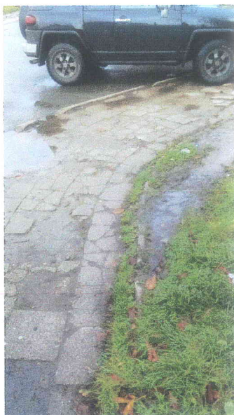
Na fot.: przy bloku Szymanowskiego 3: potrzaskane płyty chodnikowe, nierówności, kałuże, błoto, samochody tarasujące zbyt wąski chodnik
