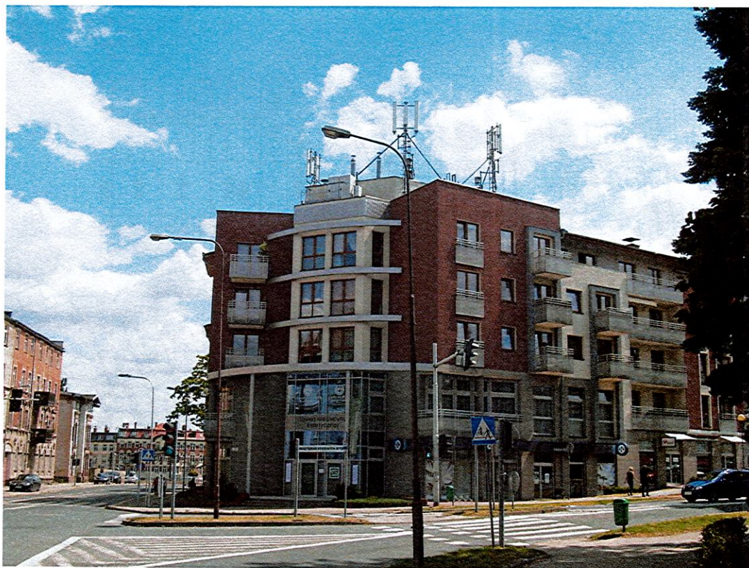
Zał. nr 1: Widok ogólny instalacji radiokomunikacyjnej.
