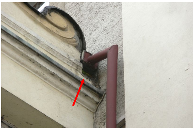
Fot. 3. Otwór pod rynną w miejscu zetknięcia łącznika z głównym budynkiem ratusza – potencjalne miejsca gniazdowania ptaków.
