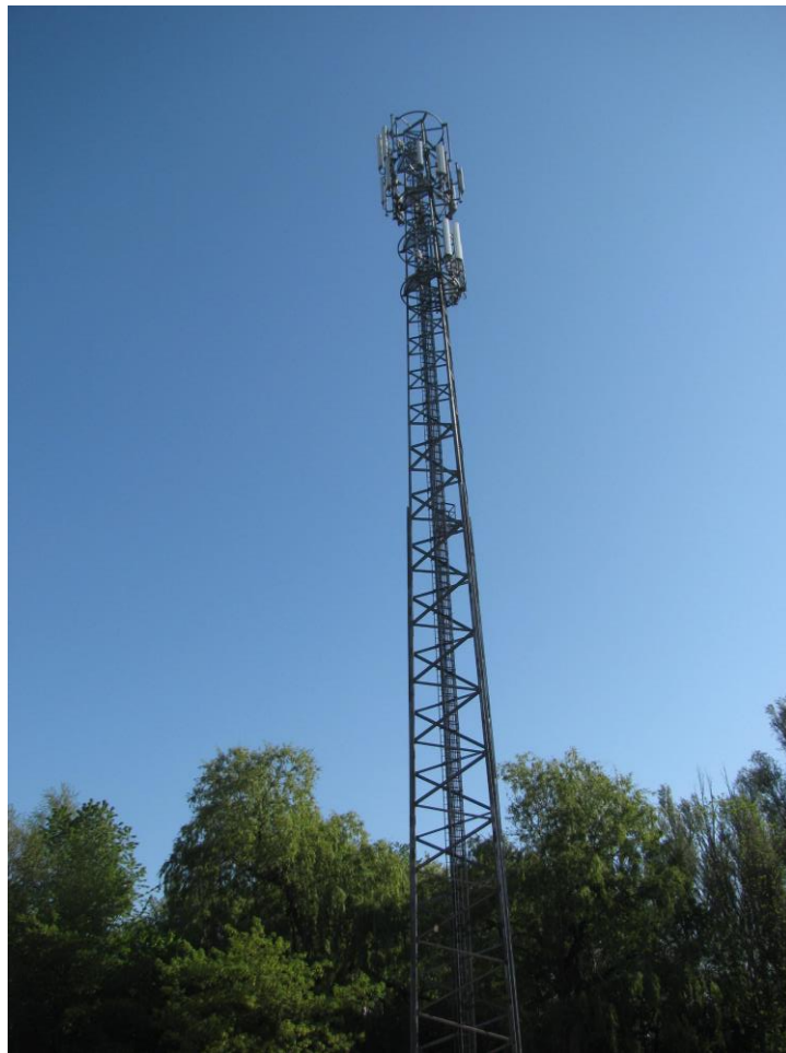
Zał. nr 1: Widok ogólny instalacji radiokomunikacyjnej.
