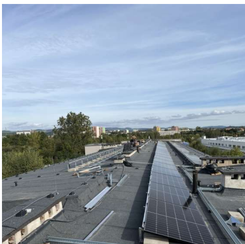
Fot. Moduły fotowoltaiczne na dachu Zespołu Szkół Elektronicznych w Jeleniej Górze
