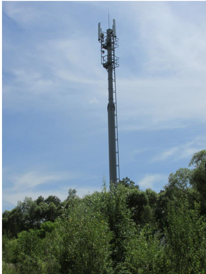
Zał. nr 1: Widok ogólny instalacji radiokomunikacyjnej.
