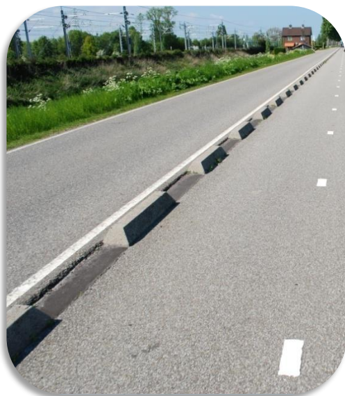
Zdjęcie 34. Holandia. Separatory betonowe.
