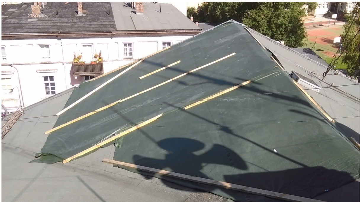
Fot.2. Dach budynku część A. Widok na miejsce przecieku od strony ulicy Wojska Polskiego
