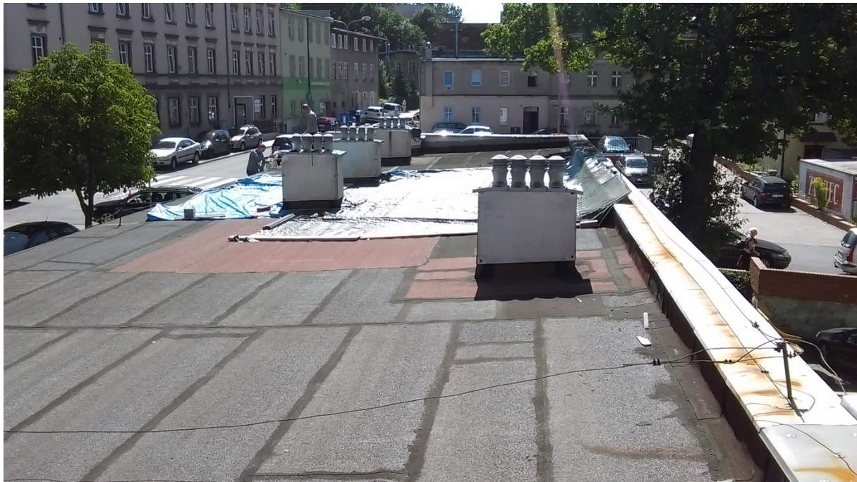
Fot.14. Dachu budynku część C. Widok ogólny- widoczne liczne miejsca napraw pokrycia .
