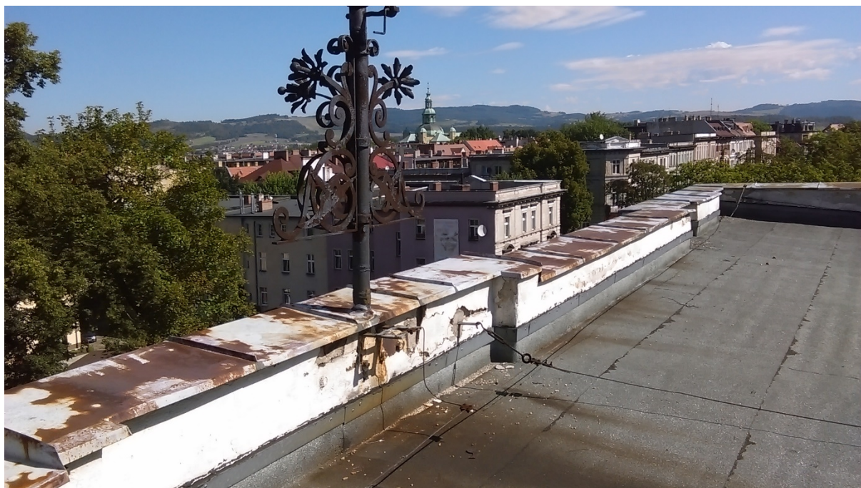
Fot.11. Dachu budynku część B. Ściana ottyki - widok skorodowanej obróbki oraz ubytki tynków oraz skorodowany maszt.
