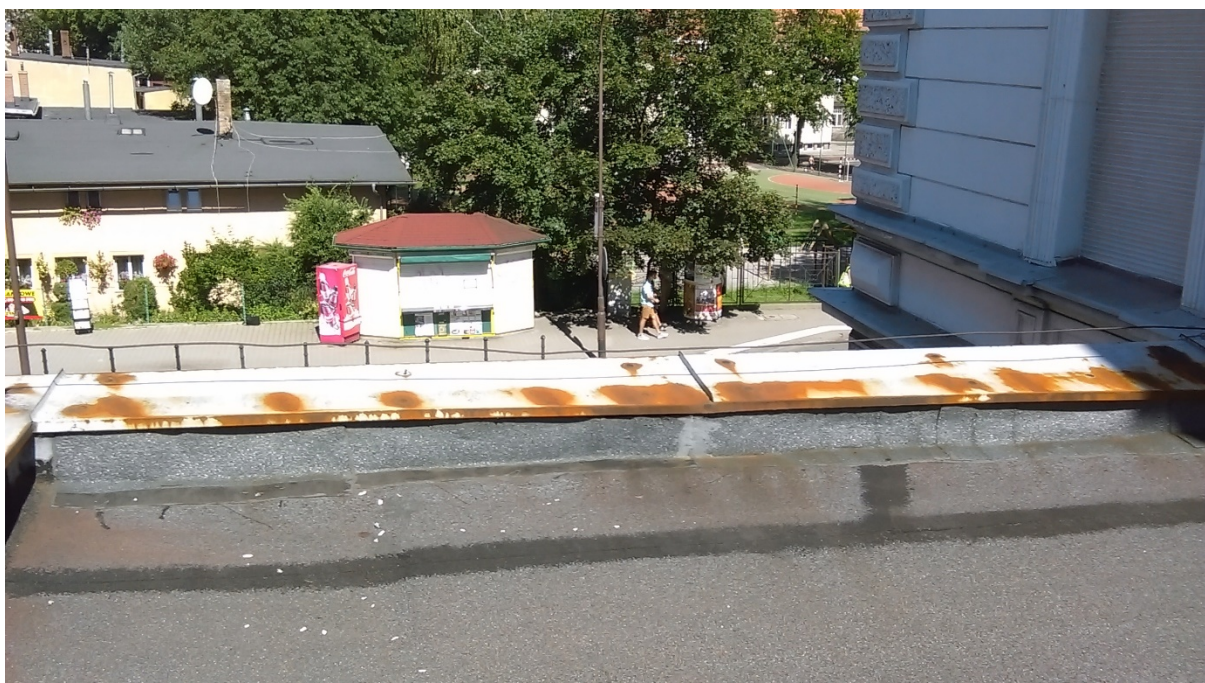
Fot.18. Dachu budynku część C. Widok na skorodowane obróbki blacharskie w części przy budynku B .
