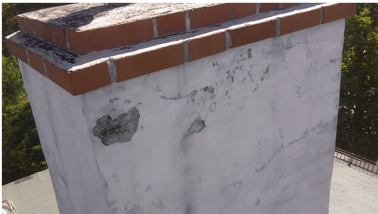
Fot.8. Dachu budynku część A. Komin wentylacyjny –widoczne ubytki i spękania tynku .
