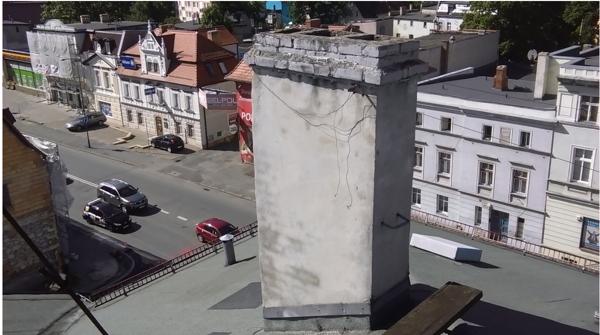
Fot.3. Dachu budynku część A. Widok ogólny na komin od strony Sudeckiej .
