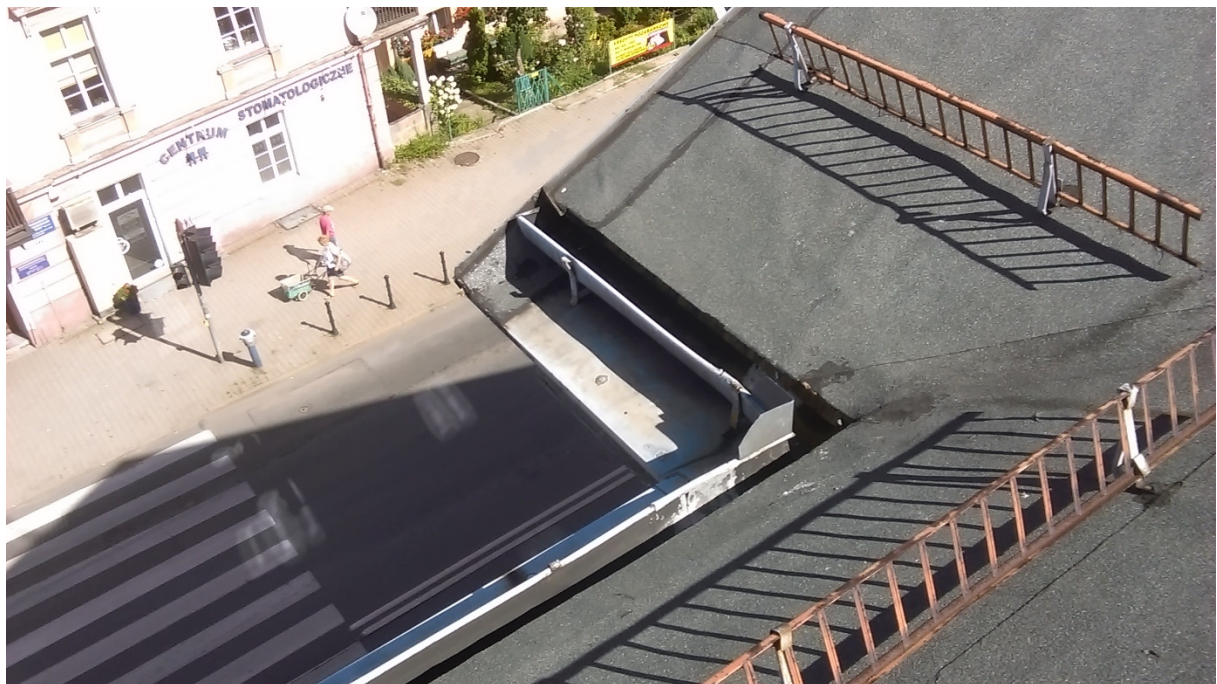
Fot.6. Dachu budynku część A. Widok na część koszową -obróbkę gzymsu i rynnę leżącą .
