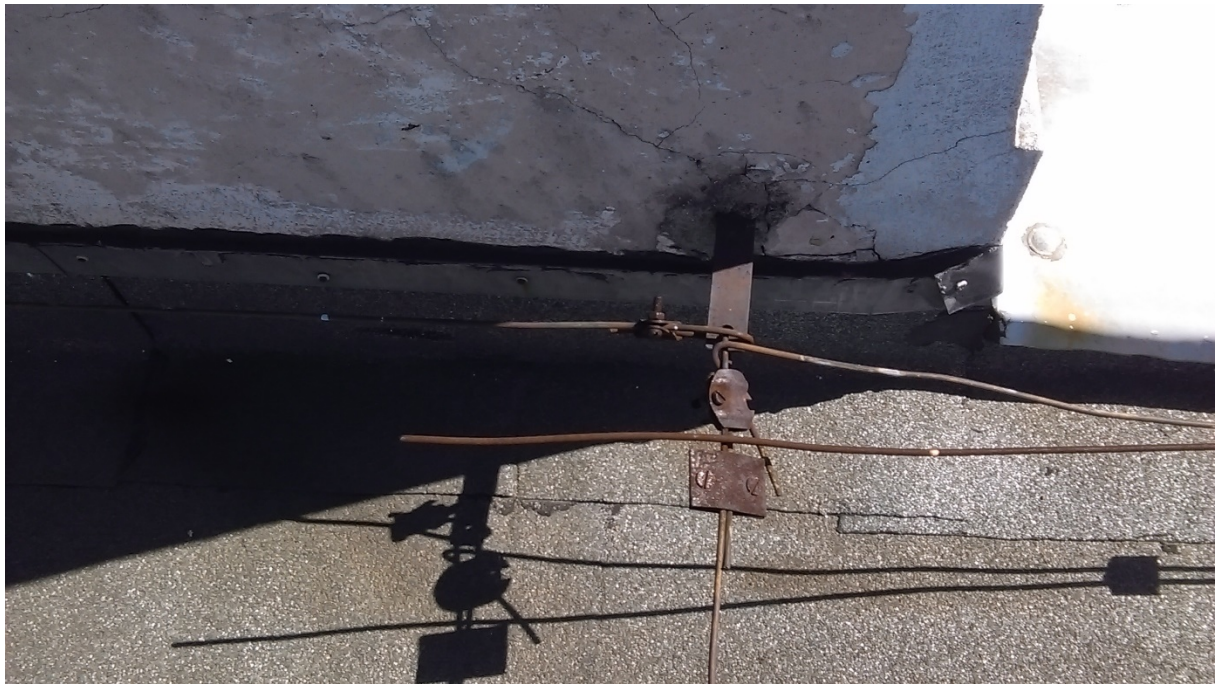
Fot.13. Dach budynku część B. Widok na skorodowaną instalację odgromową oraz na spękania i uszkodzenia tynków ściany attyki .
