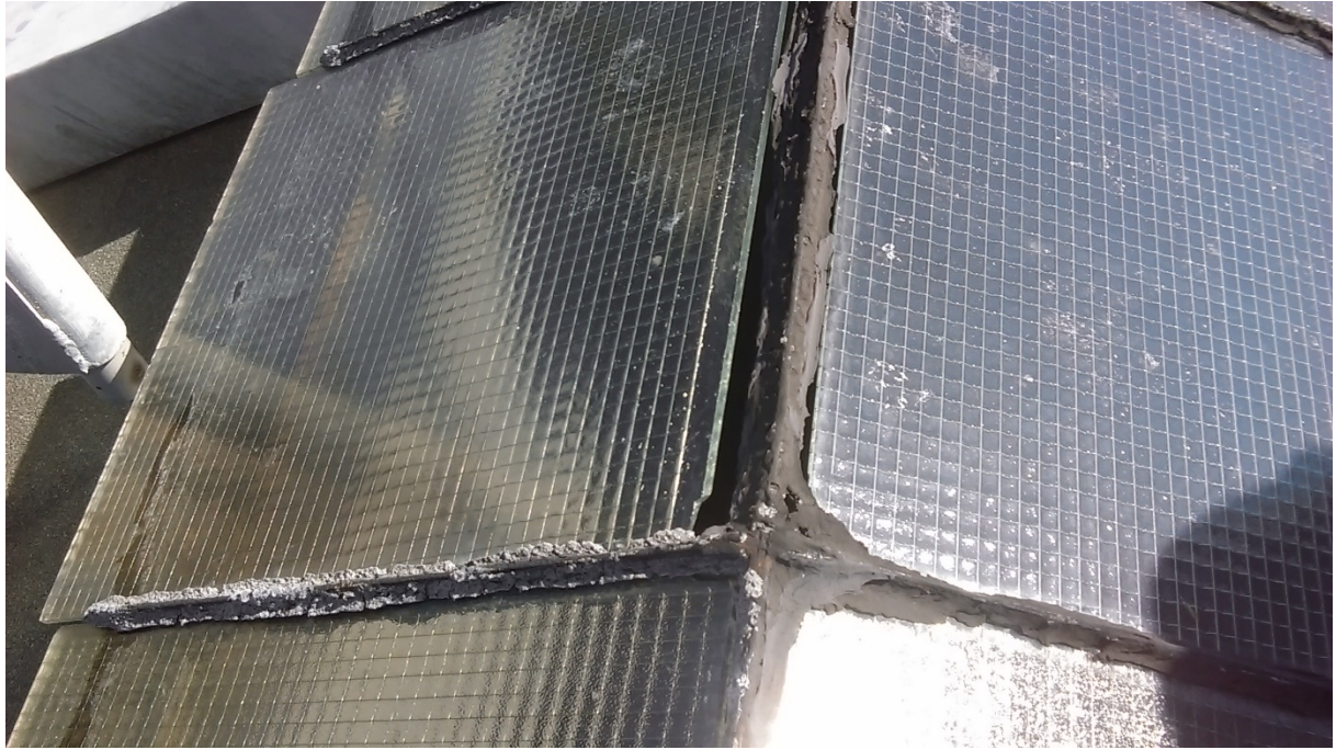
Fot.9. Dach budynku część A. Świetlik dachowy- widoczne uszkodzenia i ubytki szklenia .
